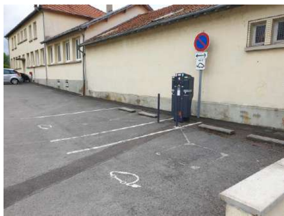
Photo 10. Borne de recharge électrique située sur le parking de l'école élémentaire
